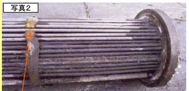
銅管内のスケール付着・堆積により 銅管は押し広げられ、パッフルプレートが破損している。
